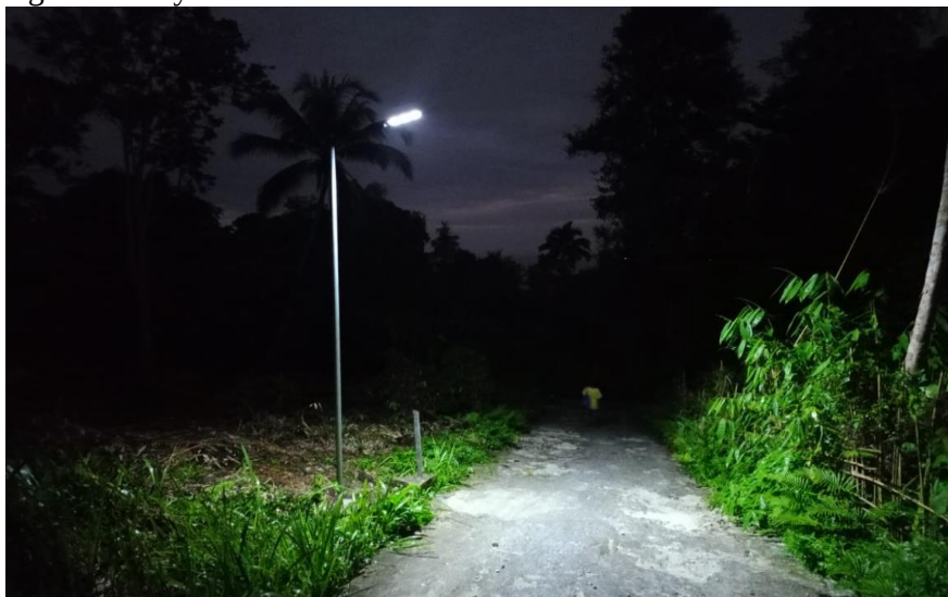
Gambar 5 Lampu Jalan Berbasis Sel Surya pada Malam Hari
