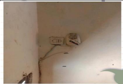
Gambar 4. Kabel yang Kurang Tertata Rapi
