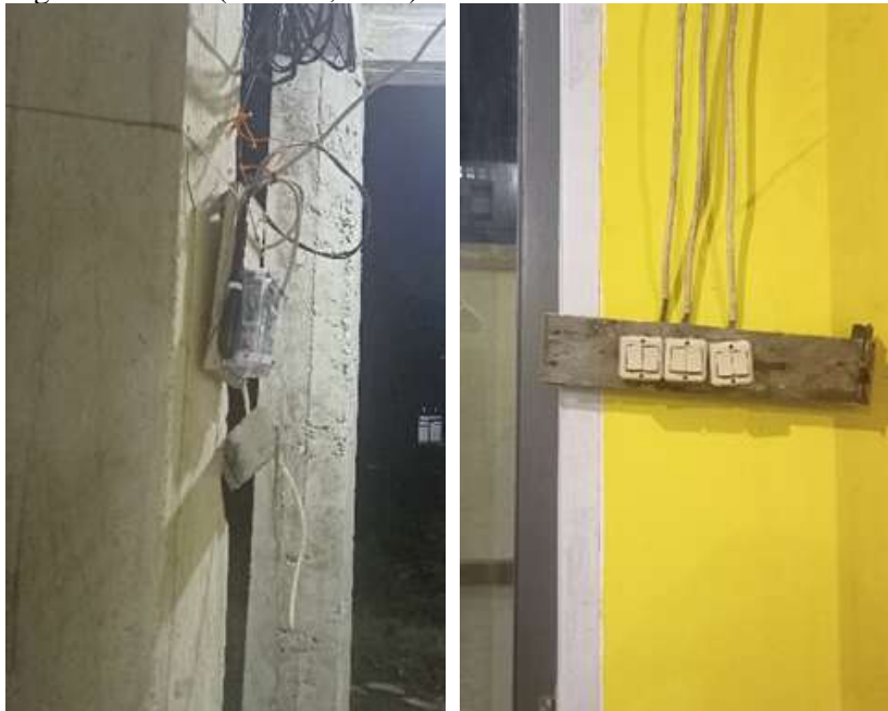
Gambar 1. Gambaran Instalasi Listrik di Kampung Tanama yang Belum Sesuai Standar PUIL
