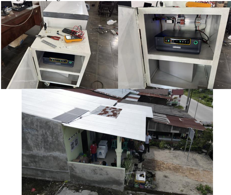
Gambar 5. Perancangan dan pengujian Sistem Cold Storage dan pemasangan panel surya di Lokasi PKM
