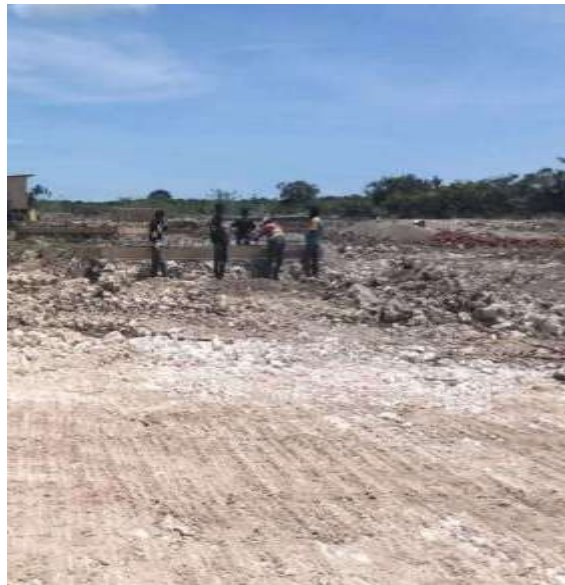
Gambar 3. Kondisi Jalan Rusak Desa Malalanda, Buton Utara, Sulawesi Tenggara.
