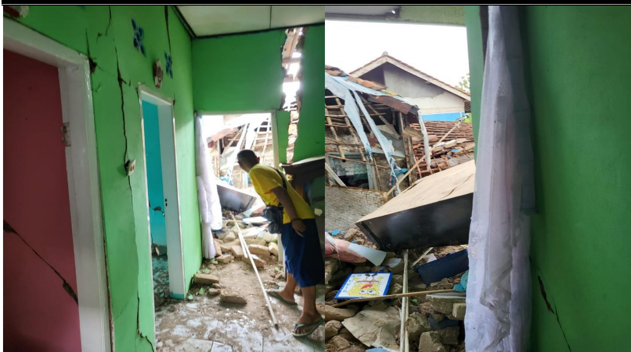
Gambar 2. Kondisi Rumah-Rumah Pasca Gempa
