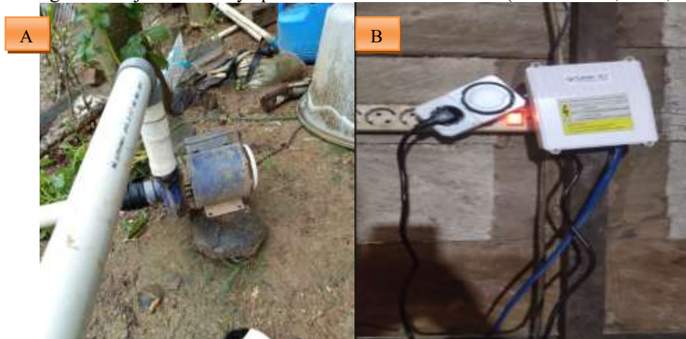
Gambar 2. (a) Pompa Air ; (b) Instalasi Pompa ke PLN
