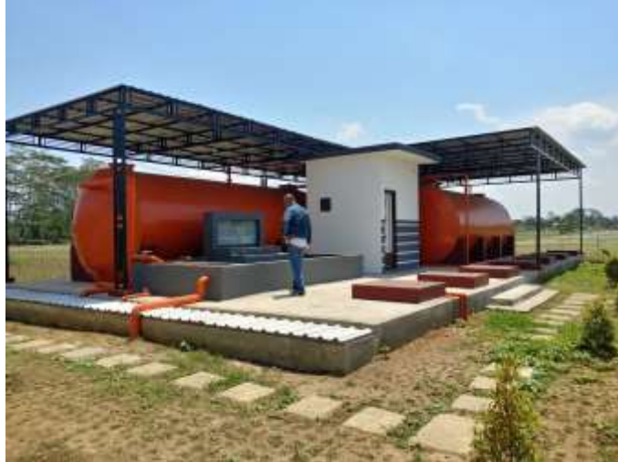
Gambar 2. Instalasi Pengolahan Air Limbah Rumah Sakit Wawa Husada
